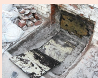
防水層切り取り
